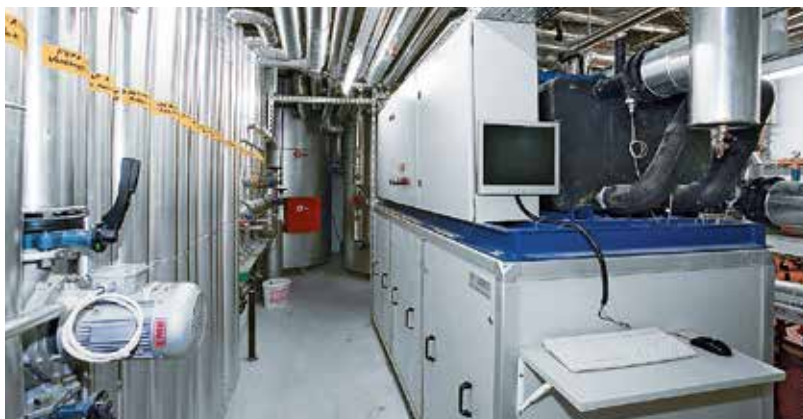
Tepelné čerpadlo na využití odpadní vody s výkonem 150 kW pro ohřev pitné vody.
